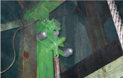
Am Saubeger Haupt- und Richtschacht wurde ein neuer Schachtenschalter installiert.
